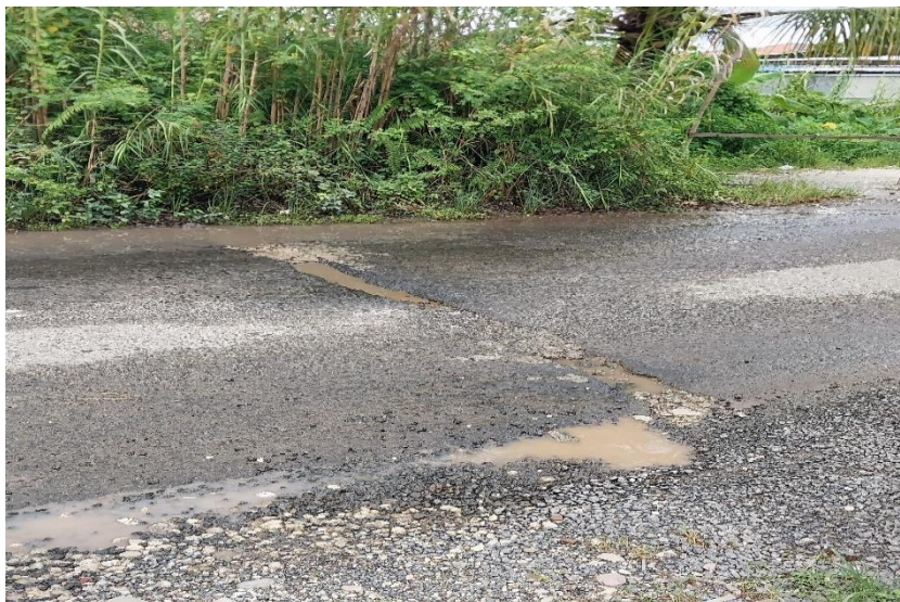
Gambar 0.1 Jalan yang berlubang di Jalan Gatot Subroto, Banjarmasin.
