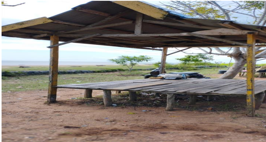
Gambar 0.6 Gajebo yang perlu di renovasi
